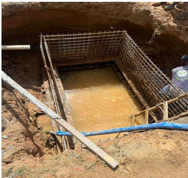
Fabricação, Montagem E Desmontagem De Fôrma Para Bloco De Coroamento, Em Madeira Serrada, E=25 Mm, 2 Utilizações. Af_06/2017
