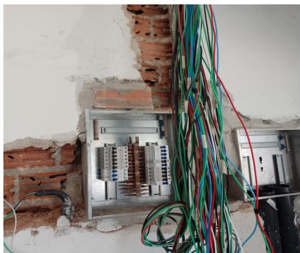
Disjuntor Monopolar Tipo Din, Corrente Nominal De 10A - Fornecimento E Instalação. Af_10/2020
