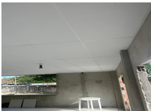
Forro acústico por painéis de lã de vidro revestidos em Pvc de micro perfurado.
