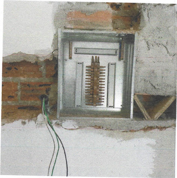
Quadro De Distribuição De Energia Em Chapa De Aço Galvanizado, De Embutir, Com Barramento Trifásico, Para 18 Disjuntores Din 100A - Fornecimento E Instalação. Af 10/2020
