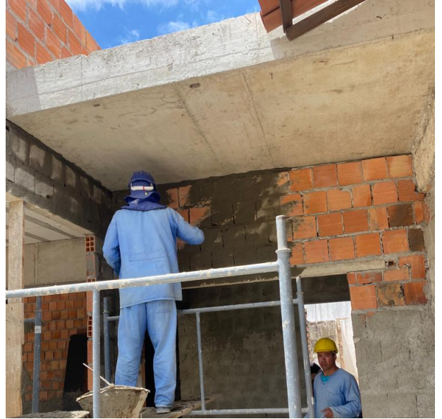
Chapisco Aplicado em Alvenaria e Estrutura de Concreto Internas, com Rolo para Textura Acrílica
