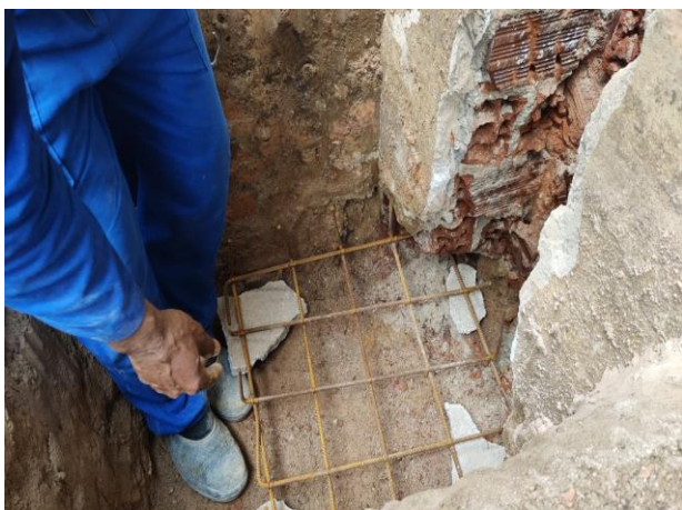
Armação de bloco, Viga Baldrame ou Sapata Utilizando Aço Ca-60 de 5MM
