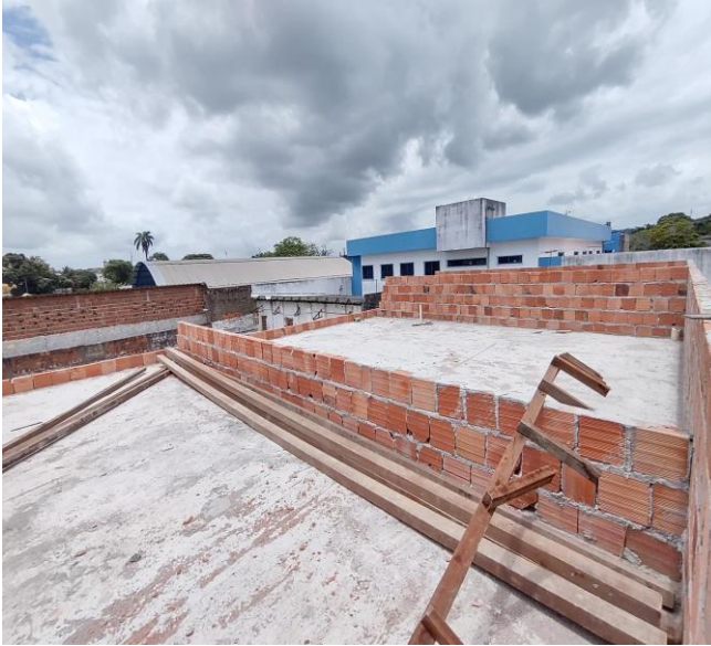
Serviço de Alvenaria de Vedação de Blocos Vazados de Cerâmica de 9x19x19cm
