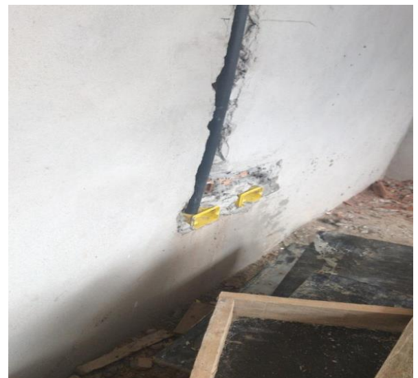
Instalação Elétrica (foto 2)
