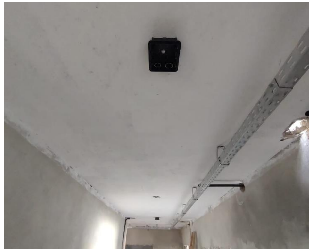
Caixa Retangular 4" X 2" Baixa (0,30 M Do Piso), Pvc, Instalada Em Parede - Fornecimento E Instalação
